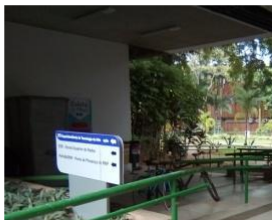
Figura 10 – Corrimãos e guarda-corpos em bom estado de conservação no PAF II, entre o Instituto de Matemática e a STI:
