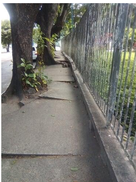
Figura 9 – Estado atual da calçada na Avenida Ademar de Barros
